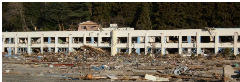
津波に流された民家が屋上に乗った雄勝小学校校舎と児童が避難した裏山
