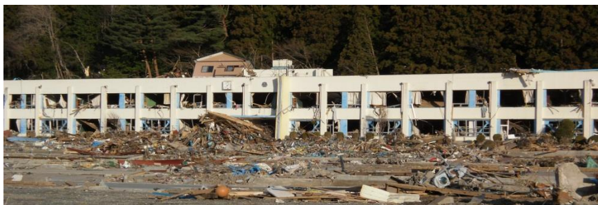
津波に流された民家が屋上に乗った雄勝小学校校舎と児童が避難した裏山
